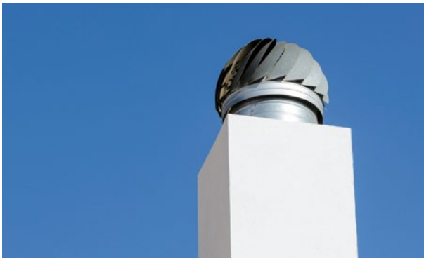
Extracteur de fumée en sortie de conduit.
