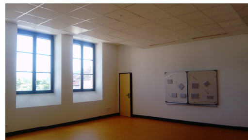
Salle de classe typique, avec réseau tuyaux dans le faux plafond.
